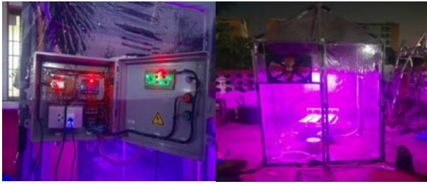
รูปที่ 3 การทดสอบระบบควบคุมความชื้นสัมพัทธ์ภายในโรงเรือน
