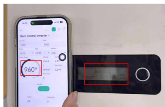
รูปที่ 11 แอปพลิเคชันบนโทรศัพท์มือถือที่ควบคุมและสถานะของอินเวอร์เตอร์หลังใช้การจำกัดกำลังไฟฟ้าที่ร้อยละ 60
