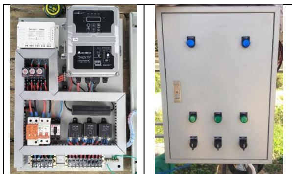
รูปที่ 4 ตู้ควบคุมระบบสูบน้ำพลังงานแสงอาทิตย์เปิดปิดผ่านสมาร์ตโฟนสูงสุด 3 โจน
