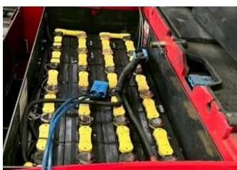
รูปที่ 2 โหลดไฟฟ้าที่ชาร์จรถไฟฟ้า
