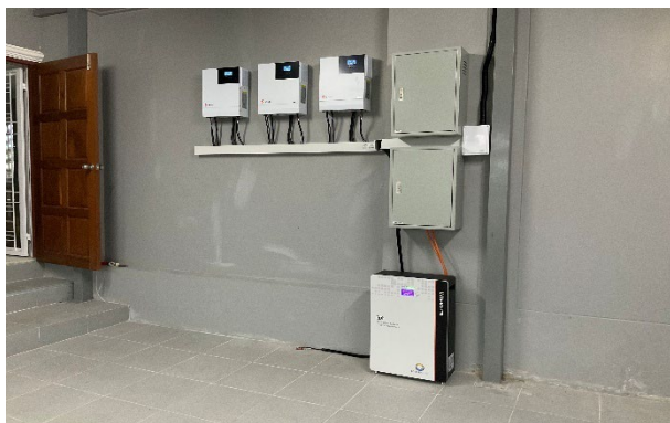
รูปที่ 5 อินเวอร์เตอร์ไฮบริดขนาด 5 kW จำนวน 3 เครื่อง และอุปกรณ์ควบคุม
