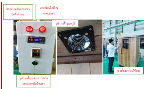
รูปที่ 6 อุปกรณ์ควบคุมอุณหภูมิและความชื้นภายในห้องอบไอน้ำสมุนไพร
