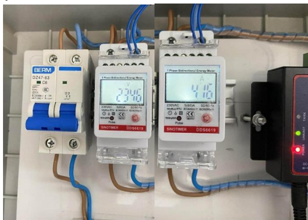
ก. การอ่านค่าแรงดัน ข. การอ่านค่ากระแสไฟฟ้า รูปที่ 7 การอ่านค่าจากสมาร์ตมิเตอร์
