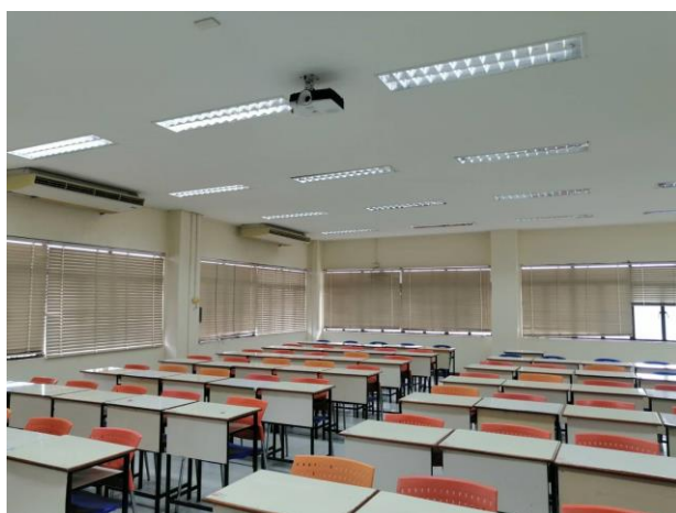
รูปที่ 4 หลอดไฟแสงสว่างภายในห้อง
