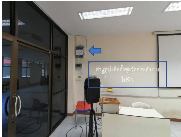
รูปที่ 3 การต่อมิเตอร์และชุดตรวจวัดค่าไฟฟ้า
