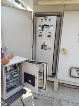
รูปที่ 11 การต่อใช้งานเครื่องกับตู้คอนโทรล
